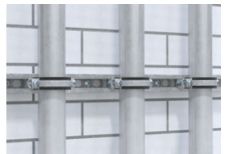
Bevestiging van waterinstallaties
